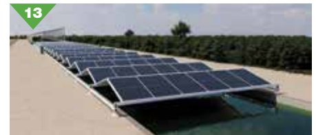
Csatorna solar – „canal-solar” megoldás M-alakú telepítéssel
